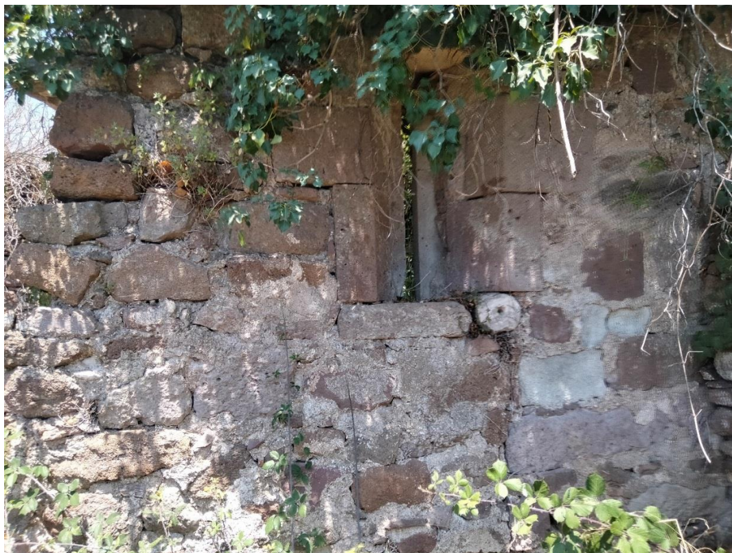
Chiesa di San Sergio. Particolare della monofora sulla parte laterale destra. Vista dall'esterno dell'aula.
